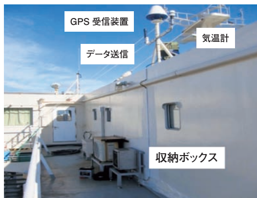
定期航路 南海フェリー「かつらぎ」に設置させていただいた GPS 受信装置
