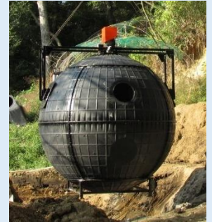
設置前のバイオガスユニット
