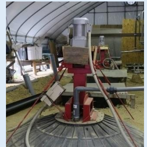
埋設されたバイオガスユニット
