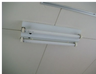
照明設備 老朽劣化
