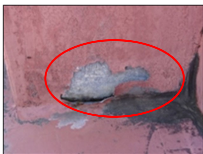
屋根 防水層の劣化
