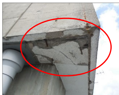
外壁 軒裏の欠損
