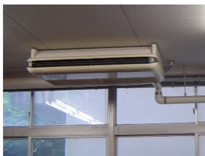
空気調和設備 老朽劣化
