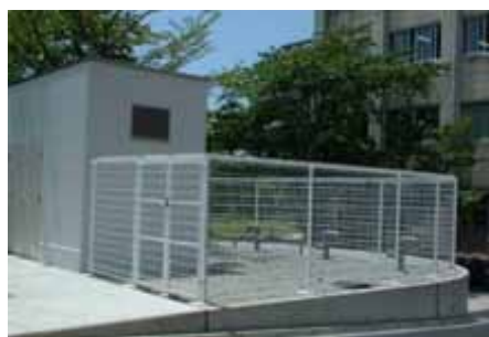
中和・曝気槽
