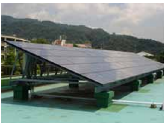
太陽光パネル
