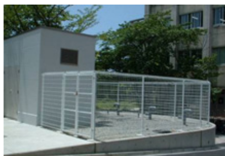
中和・曝気槽
