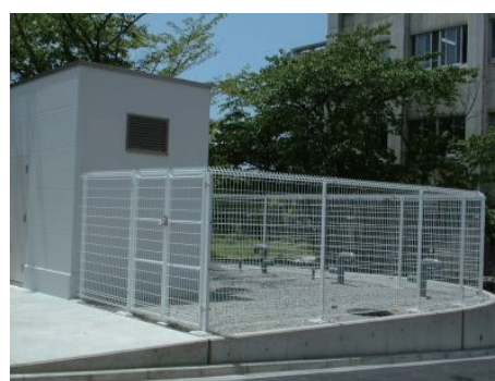
中和・曝気槽
