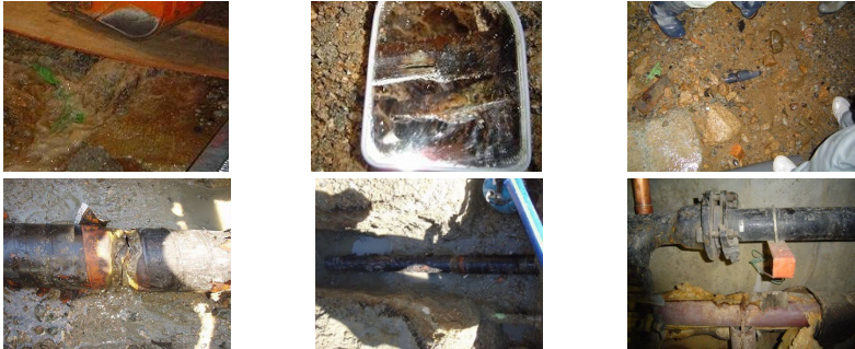
老朽した配管による漏水
