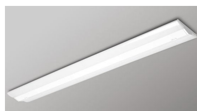
LED照明設備
