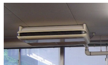
老朽化した空調設備
