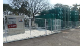
災害時給水システム
